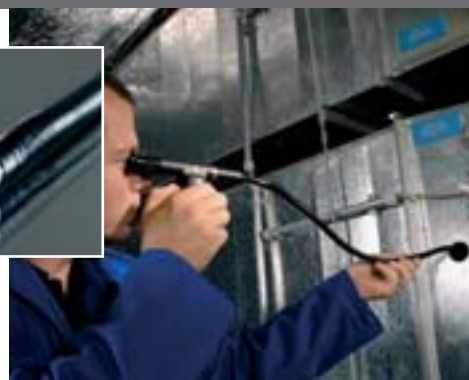
Inspección en conductos de aire acondicionado, con funda de cuello de cisne de flexibilidad media
