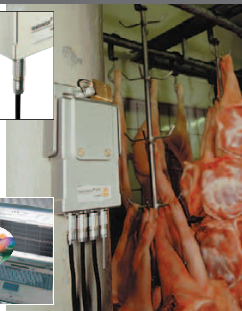
Control de varias cámaras frigoríficas con el testostor 171-4
