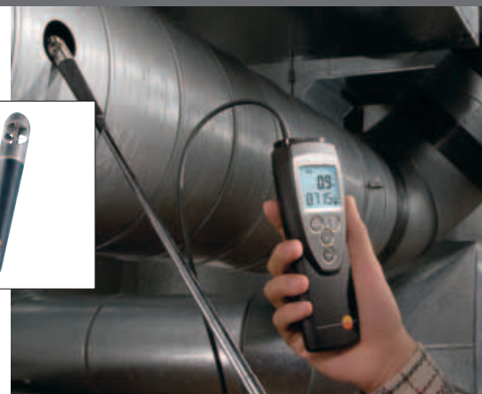
Control de la velocidad del aire en conductos de aire acondicionado
