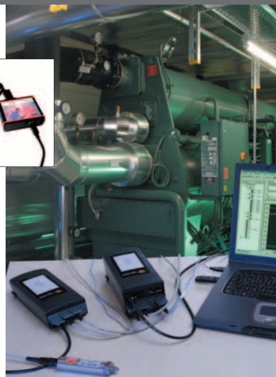
Medición del sobrecalentamiento/subenfriamiento y la presión del aceite en un sistema de refrigeración industrial
